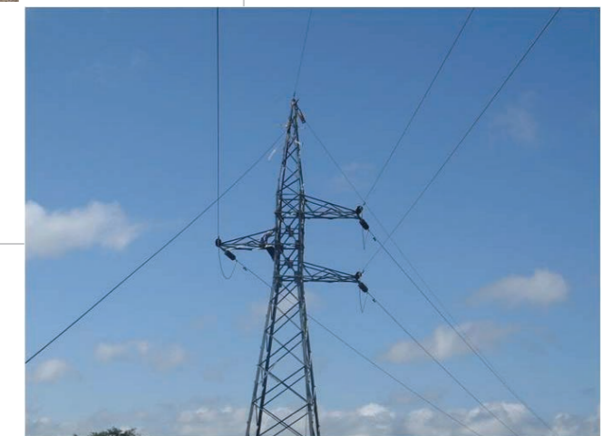
OPGW cable String
